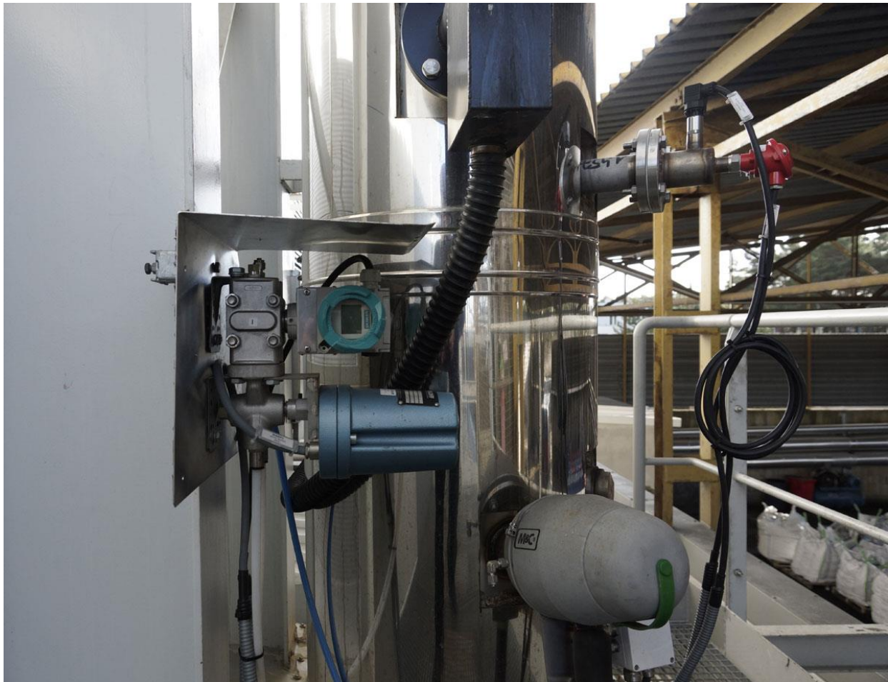
Urządzenia monitorujące zainstalowane na kominie
